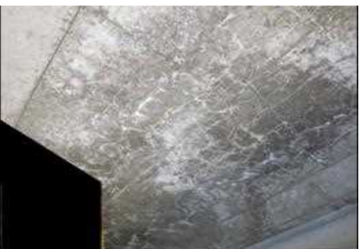
損傷: 床版コンクリートひび割れ
