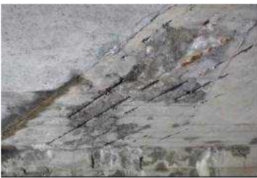
損傷: 鉄筋露出
