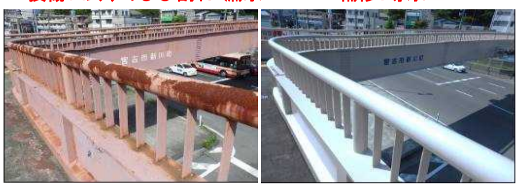
損傷: 防食塗膜の劣化 補修: 塗装塗替
