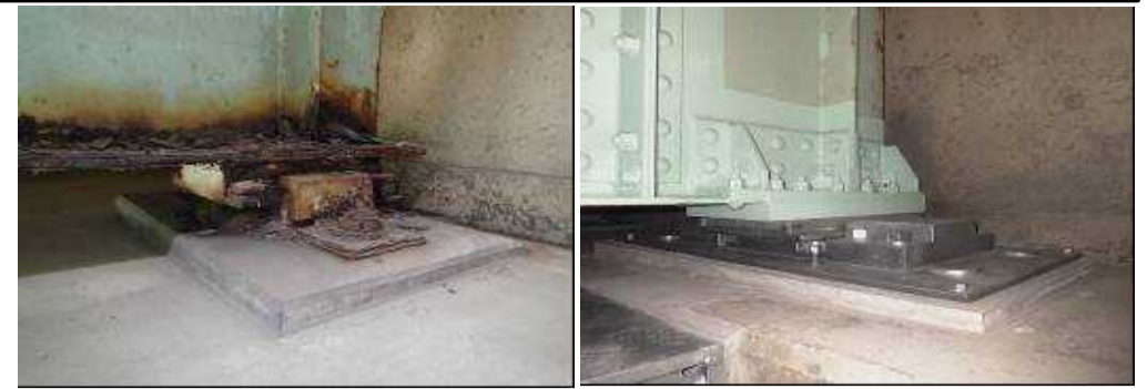
損傷: 主桁・支承腐食 補修: 主桁あて板・支承取替
